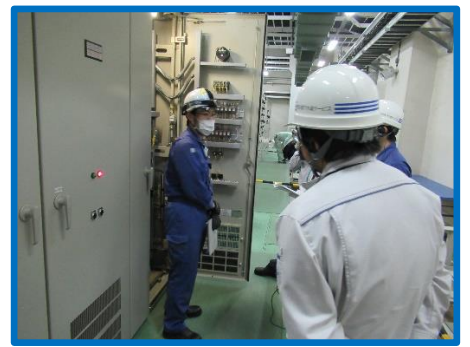
③ 【施設運転・保全】
