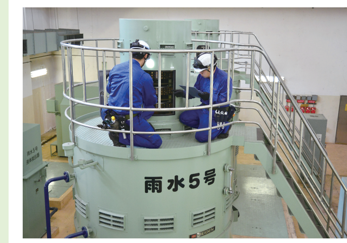
●水再生センター・ポンプ所の維持管理
